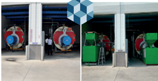
金鼎綠能提供生質能源木顆粒並設計安裝客製化木顆粒燃燒機,廠商移出原鍋爐的燃燒機(左)並安裝木顆粒燃燒機(右),並再配合使用木顆粒作為燃料,可降低燃燒成本,達到環保、節能減碳與清潔能源之功效。
